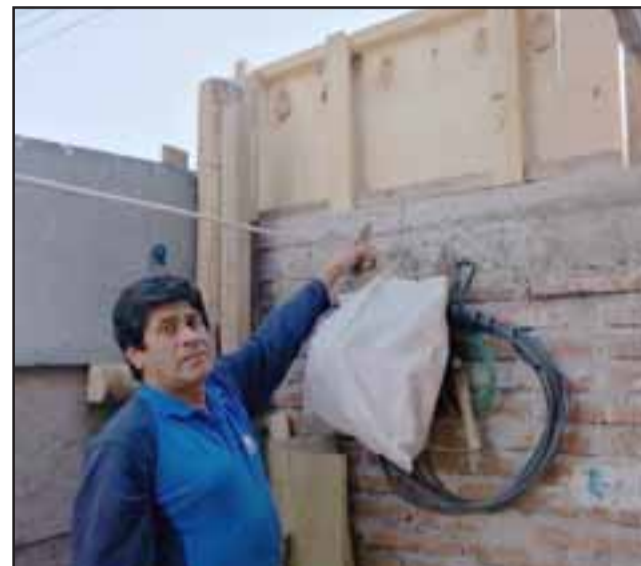
El afectado nos muestra por donde los delincuentes ingresaron debiendo elevar el muro que colinda hacia la vía pública.
