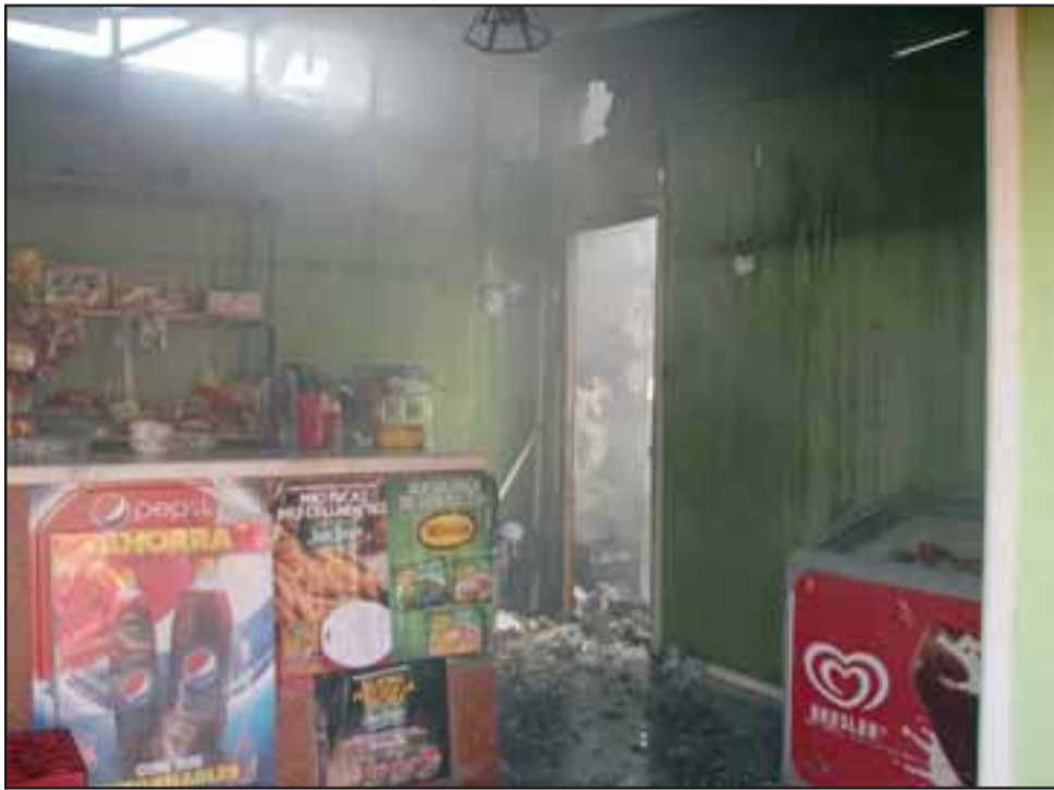
Daños prácticamente totales en un local comercial, y parciales en una bodega y en parte de la techumbre del Centro de Eventos 'El Negro Bueno'.
