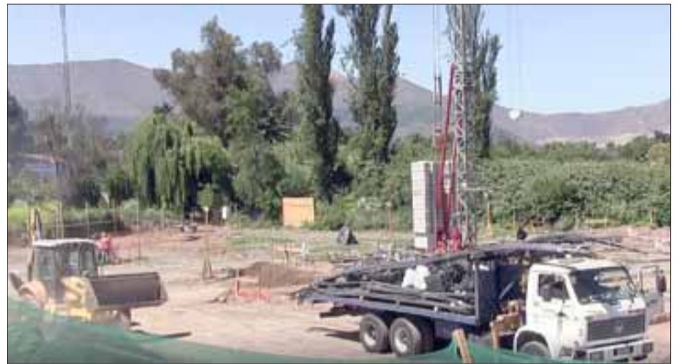
En plena ejecución están las obras de construcción del nuevo edificio del centro de salud familiar (Cesfam) de la comuna de Panquehue.
