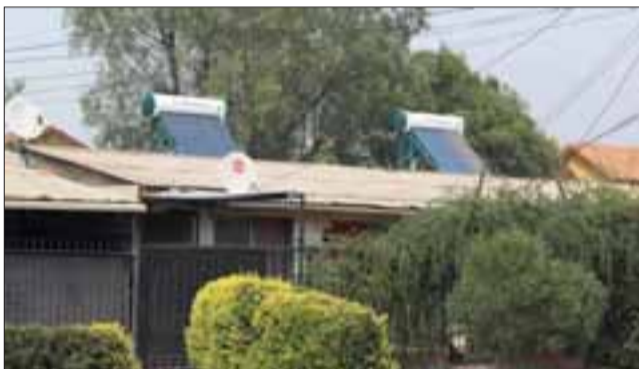
Los vecinos que ya tienen instalados los paneles, han podido acceder al agua caliente en toda la red de agua con la que cuenta su vivienda, sistema que se ve favorecido por las condiciones climáticas que es posible observar en esta zona.
