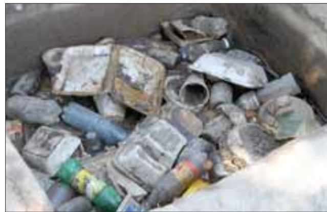
PREOCUPANTE SITUACIÓN.- Así están algunas cámaras de los canales en alameda Bernardo O'Higgins, el Municipio asegura que se limpian semanalmente, mientras que los vecinos afirman lo contrario.
