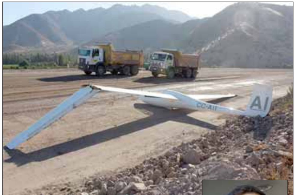
El planeador se estrelló en medio de la carretera en construcción de la ruta 60 CH en San Felipe. (Fotografías: Roberto González Short).
