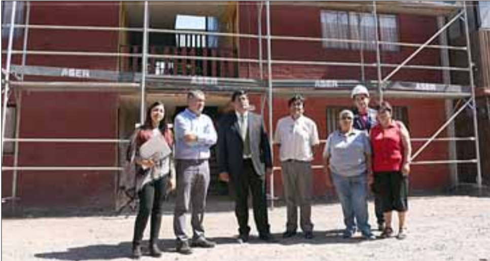
Entre las obras que se aplicarán en el sector, contempla el retiro de planchas en techos de asbestos cemento, cambio y reposición de techumbre, nuevas instalaciones de canales y bajadas de aguas-lluvias, reposición de escalas y barandas.
