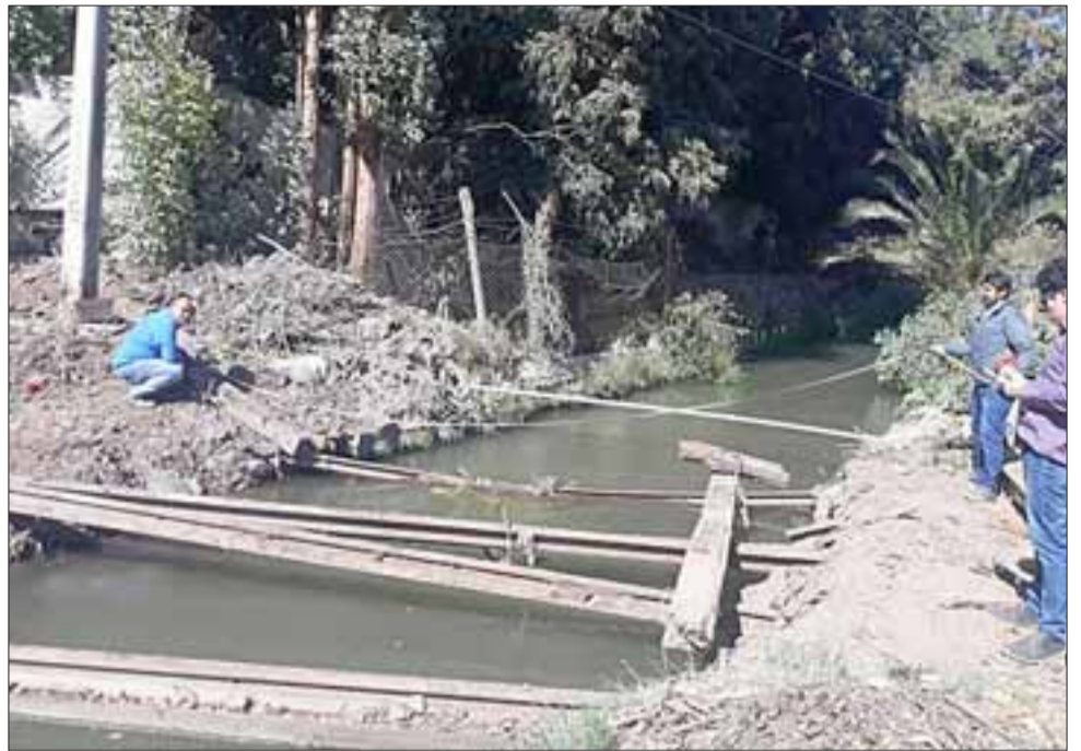
Así quedó el puente en ese sector rural de Llay Llay, luego que colapsara.
