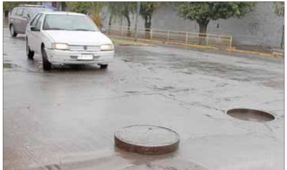
PELIGRO. - En algunas vías de nuestra ciudad, la presión del agua era tal que removió las pesadas tapas del alcantarillado, generando peligro a conductores y peatones.
