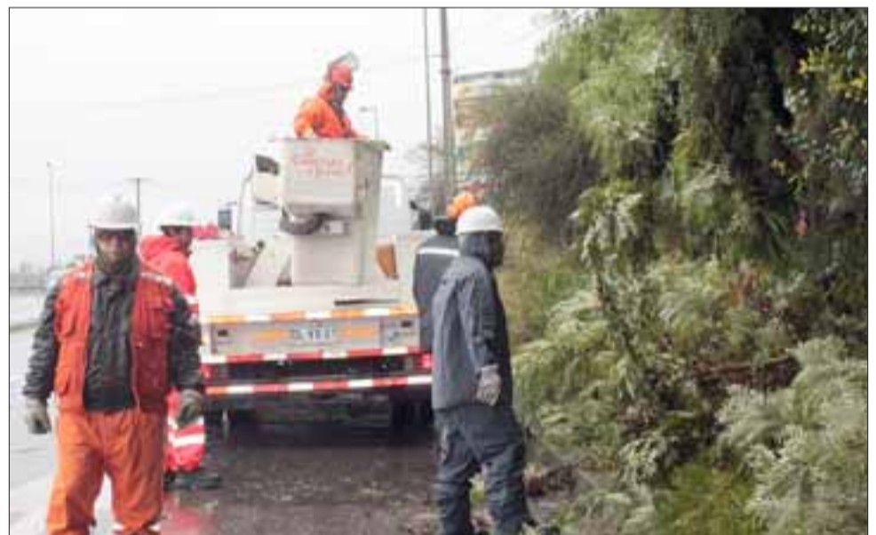
CORTE ELÉCTRICO. - Frente al puente que conecta a 21 de Mayo, un árbol cayó sobre el tendido eléctrico, generando un corte de electricidad en horas de la mañana. Chilquinta atendió la situación.
