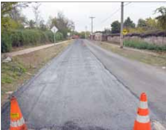
El Alcalde Claudio Zurita se constituyó en el camino San Luis para observar el trabajo de asfalto, valorando la iniciativa de mejorar estas vías.
