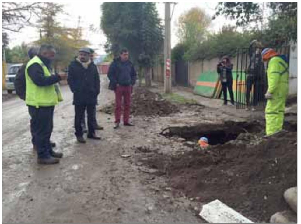
El Alcalde (s) Patricio González visitó el sector y lamentó la información errónea que se ha entregado a los vecinos, que señalaba que las obras se encontraban paralizadas.
