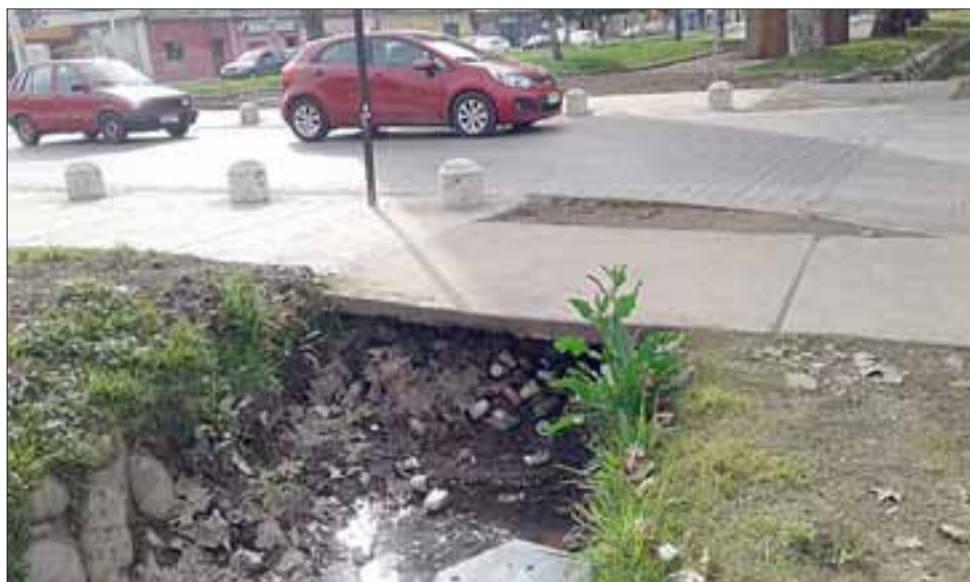
Acá se puede apreciar que en este canal ubicado en la intersección de Avenida Yungay con Merced, hay basura al interior.
