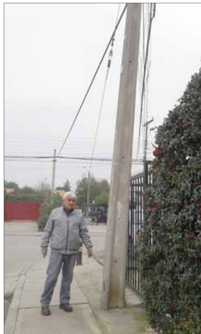
El vecino Hernán Rivera Paz nos muestra lo inclinado que está el poste ubicado fuera de su casa.
