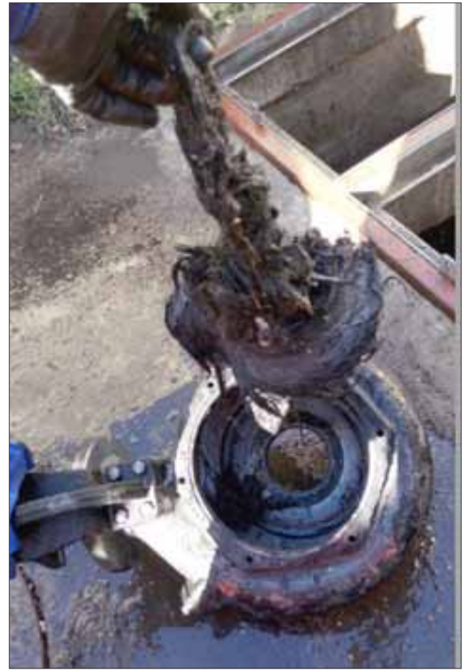
Paños de cocina, trapos y otros desechos domiciliarios obstruyeron la bomba que impulsa el agua hacia la planta de tratamiento, generando los malos olores.
