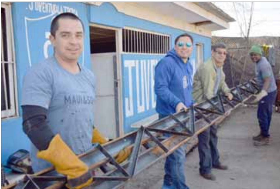
CON RECURSOS PROPIOS. - Ayer lunes las cámaras de Diario El Trabajo registraron el momento cuando instalaban barras de metal para detener esta ola de robos en la sede.
