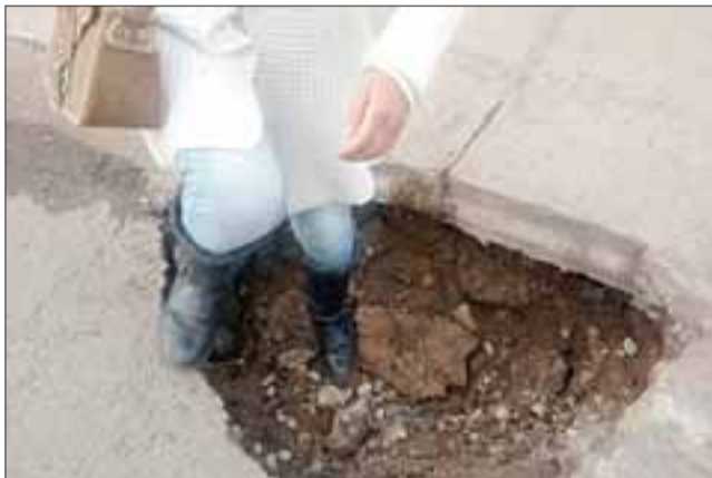
Acá la misma vecina con un pie dentro del agujero para verificar la profundidad del evento.
