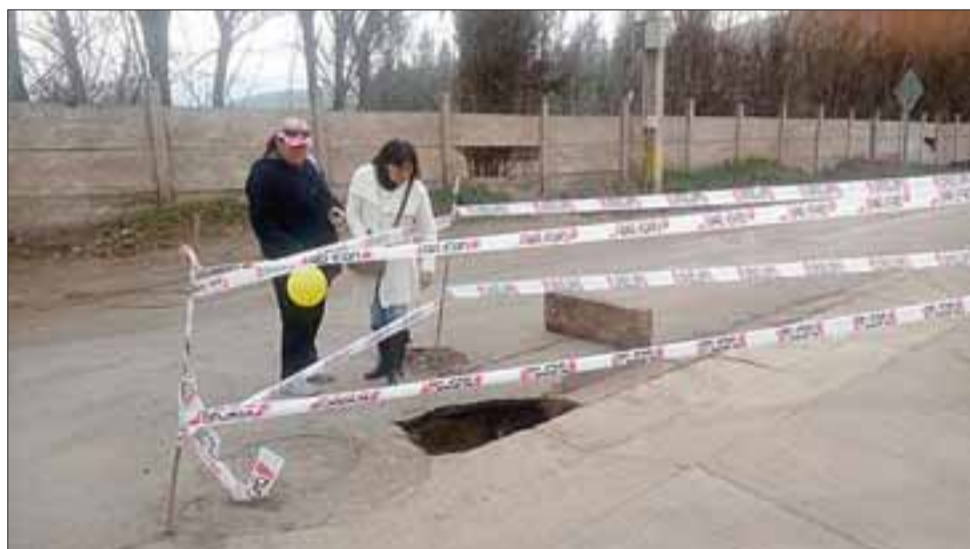
Vecinas del sector observan la profundidad del evento.
