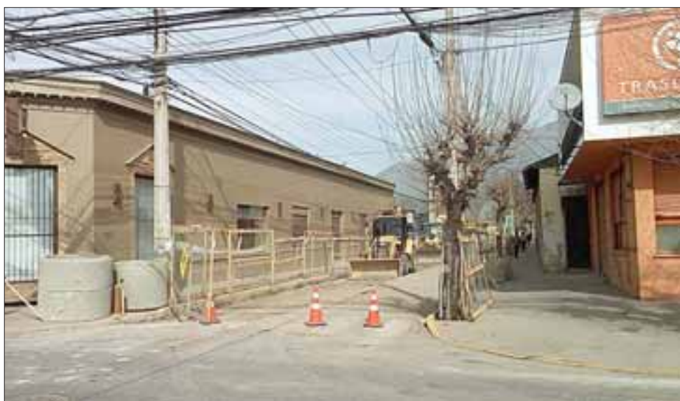
Trabajos de renovación de la infraestructura de la red de alcantarillado en Calle Traslaviña -entre Freire y Santo Domingo-, podrían ser entregados dentro de los próximos 15 días.
