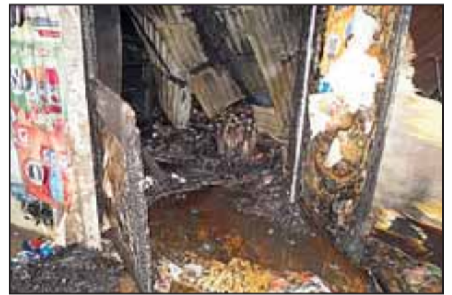
Las pérdidas materiales fueron totales. Expertos de Bomberos siguen investigando las causas del incendio.
