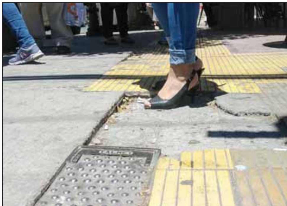
Así luce el desnivel que provoca la falta de baldosas en la esquina de Coimas con Merced. En primer plano la placa metálica donde golpeó su cabeza la anciana.
