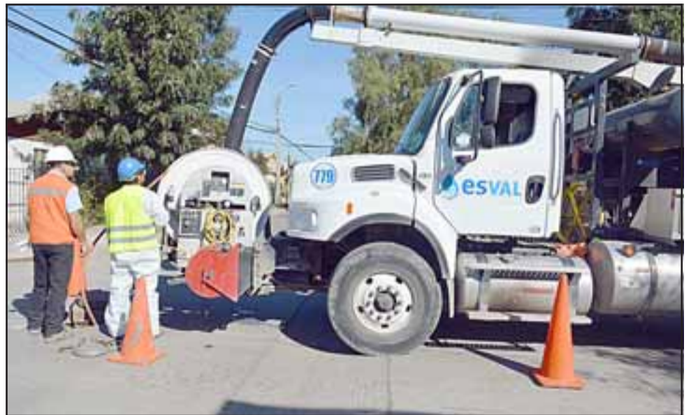
Los trabajos tienen un plazo de ejecución de 30 días por lo que estarán terminados antes de fin de año. (Foto referencial).
