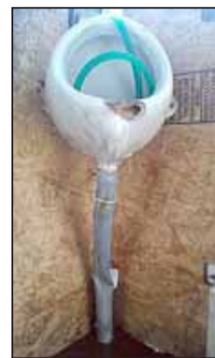
DA LÁSTIMA.- Este es el estado de los orinales que Gendarmería ofrece a sus funcionarios, hasta se podría especular que los presos cuentan con mejores instalaciones.
