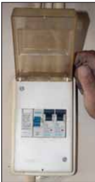
SEGURIDAD ELÉCTRICA.- Las medidas de seguridad en las instalaciones eléctricas también hablan de una clara responsabilidad del dueño de este inmueble.
