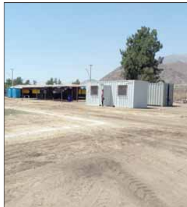
La empresa que estará a cargo de las obras ya está instalada y comenzó a ejecutar los primeros movimientos en Las Tres canchas.
