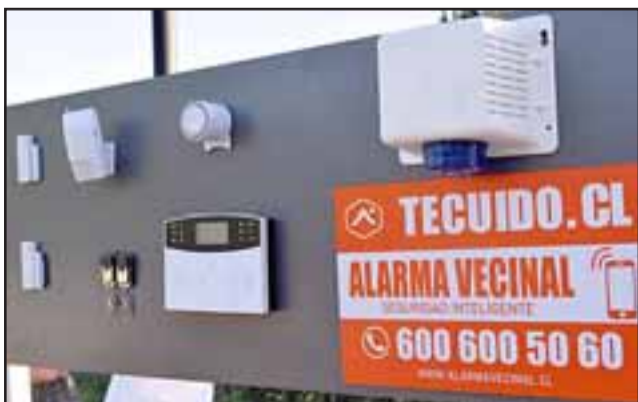
KIT COMPLETO.- Este es el panel o Kit de dispositivos que tiene cada casa instalado para beneficio de sus habitantes.
