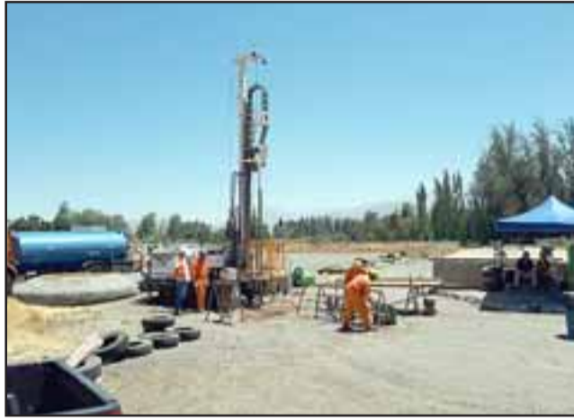
Este proyecto contará con más de 4700 metros cuadrados para su edificación en los terrenos de la ex Aduana de Hermanos Clark.
