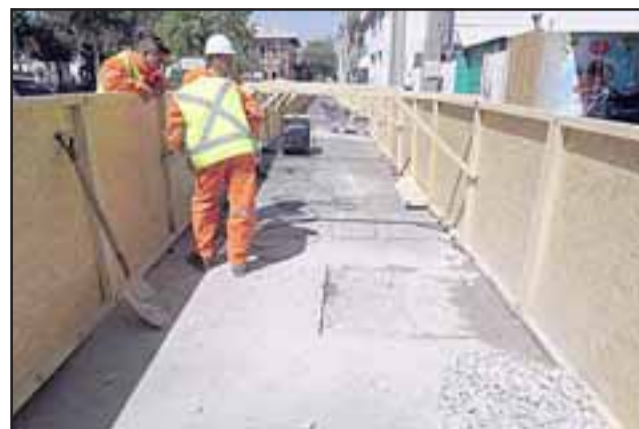
Las calicatas tendrán una profundidad de dos a tres metros con un ancho de un metro.
