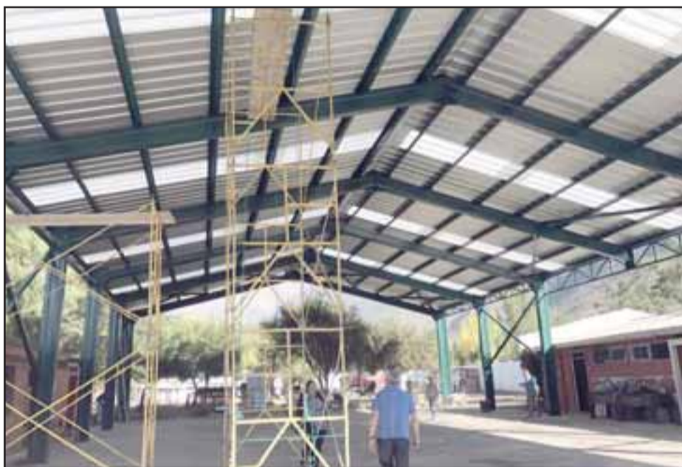
Al proyecto del nuevo techo se suma la construcción de una sala destinada a trabajar en el Proyecto de Integración Escolar.
