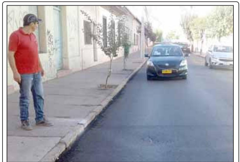
Acá apreciamos el desperfecto del asfalto que se ubica en calle Coimas casi al llegar a la Avenida Chacabuco. (Foto RP)
