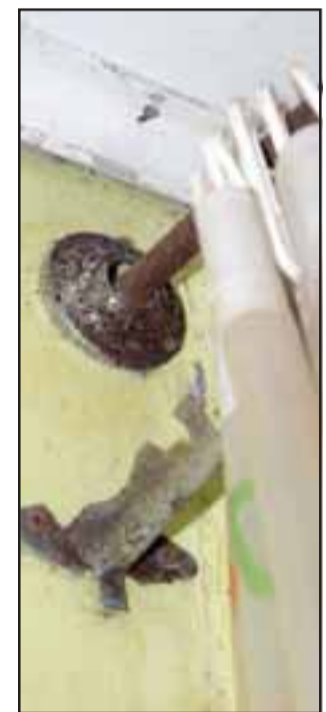
ÓXIDO Y HUMEDAD.- Así están los implementos en el baño que actualmente usa esta familia Ilayllaína.
