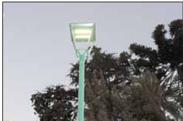
Esta obra, financiada por la Subsecretaría de Prevención del Delito, demandó una inversión de $39.101.325, y consideró la instalación de luminarias, escaños y basureros.
