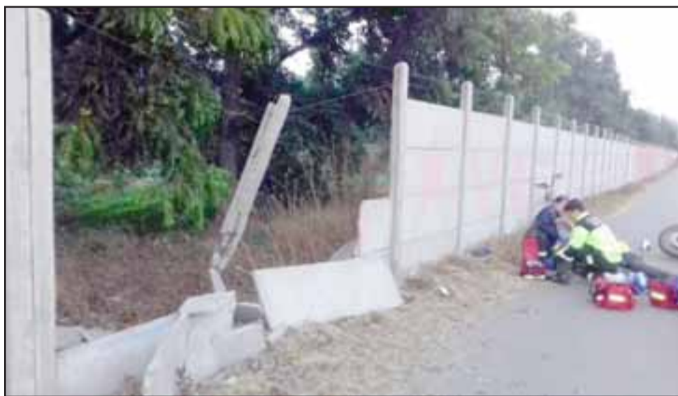
El motorista impactó contra este muro a gran velocidad, resultando con lesiones de consideración.
