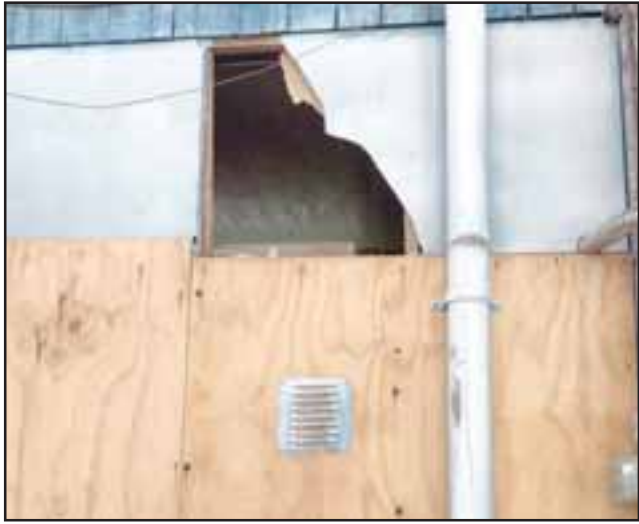
MISMA TÉCNICA. - Por este forado ingresaron los desalmados delincuentes. El empresario afectado asegura estar ya aburrido de esta situación.
