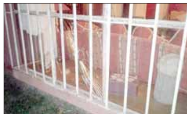
El vidrio de una de las ventanas fue quebrado por el o los antisociales que ingresaron a la vivienda.
