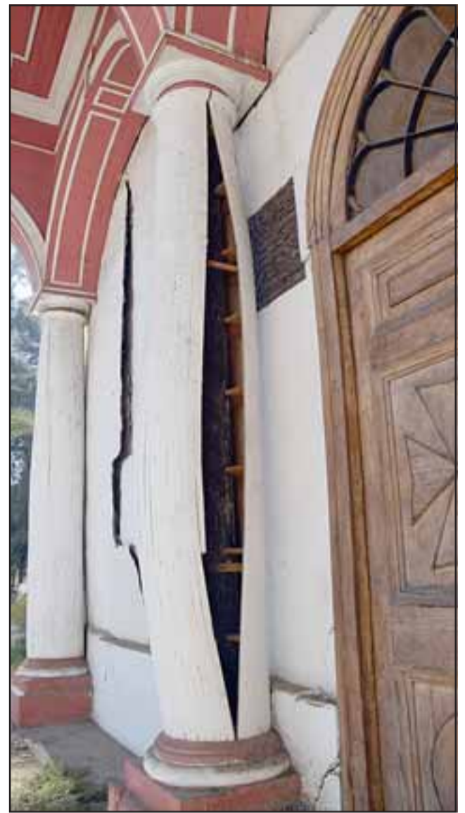
¿RESISTIRÁN CUATRO AÑOS?- Así están las columnas principales, o de la fachada del templo, inservibles, muy dañadas y sin decoro alguno.
