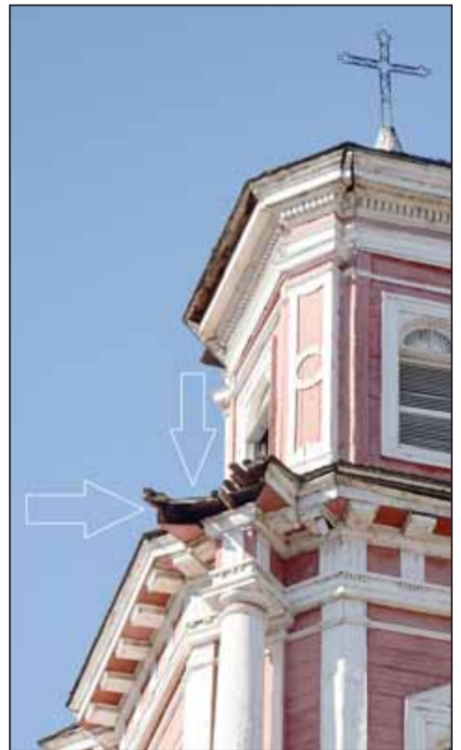
TRISTE MONUMENTO.- La torre de esta iglesia también está en muy pésimas condiciones, la madera se ha caído poco a poco.
