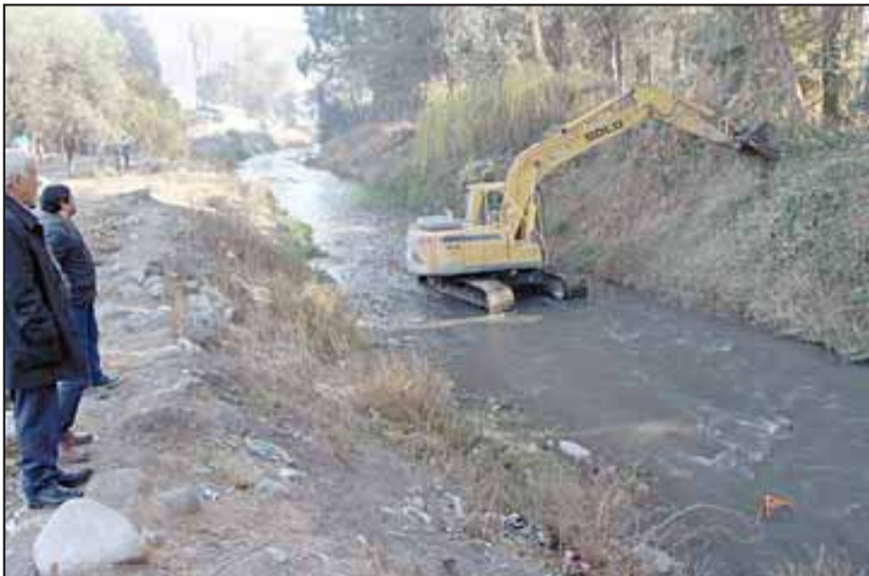
El alcalde Patricio Freire junto al equipo de la municipalidad, inspeccionaron este viernes la labor que están realizando en el estero Pocuro con el retiro de basura que impida el normal cauce del agua.
