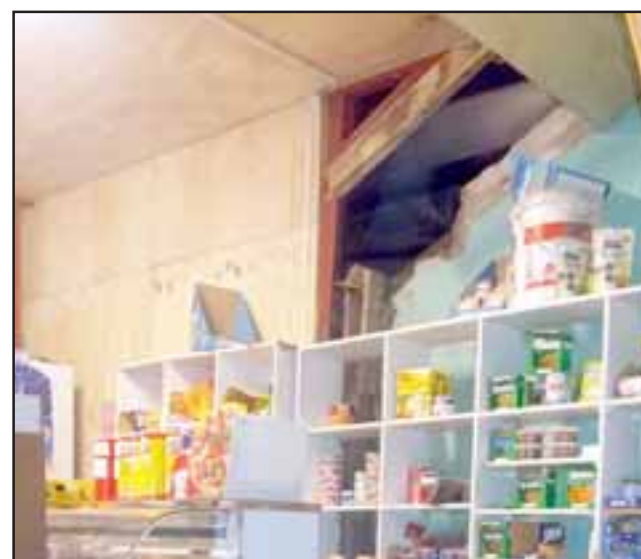
Los delincuentes habrían efectuado este forado para escapar hacia las techumbres para no ser descubiertos.
