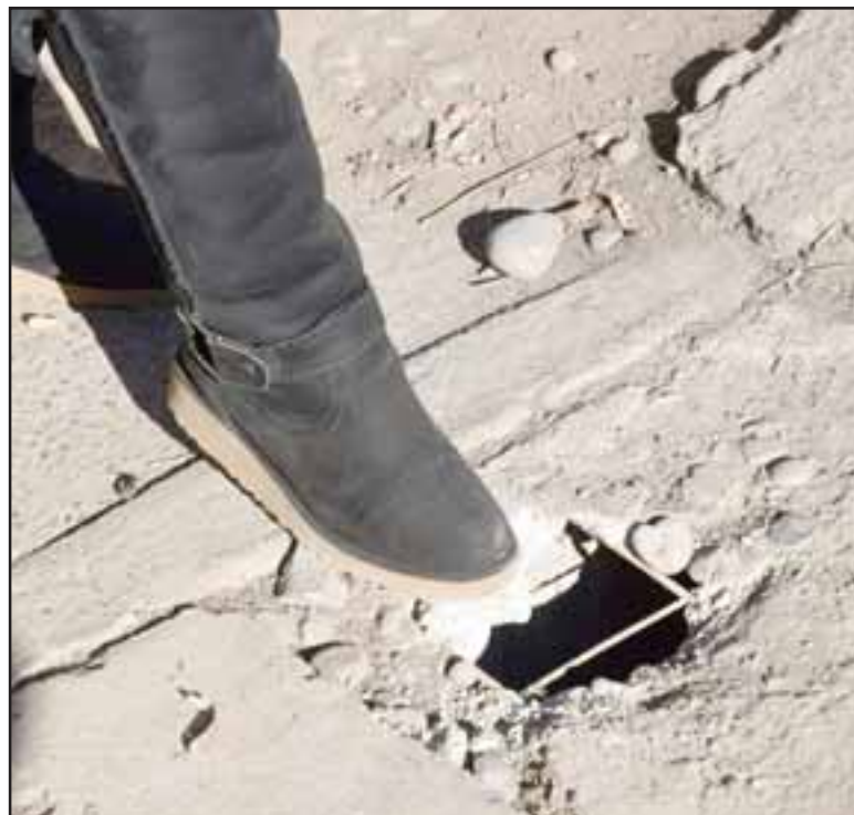
TAPAS DAÑADAS. - A la salida de la calle vemos algunas tapas dañadas, cualquier persona podría caer si queda prensado en estos hoyos.
