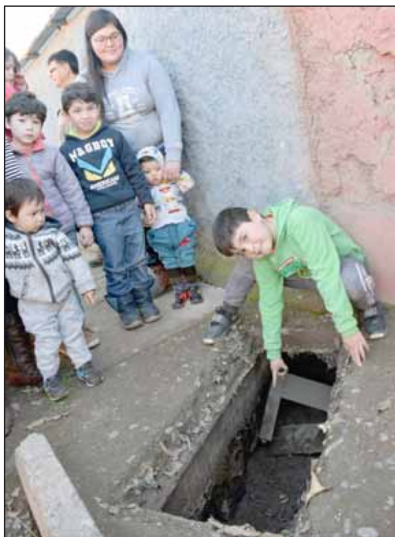
PELIGRO AL PASAR. - El niño Gonzalo Villarroel muestra a Diario El Trabajo esta cámara sin tapa, la que aún no ha sido terminada por la empresa encargada.
