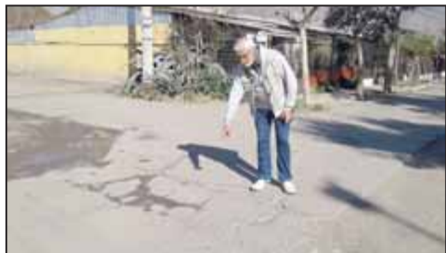
El vecino muestra lo deteriorado que está el pavimento producto del alto flujo vehicular.
