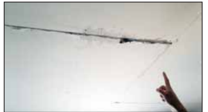
El principal problema decía relación con los techos que se llovían, los cuales están siendo reparados.
