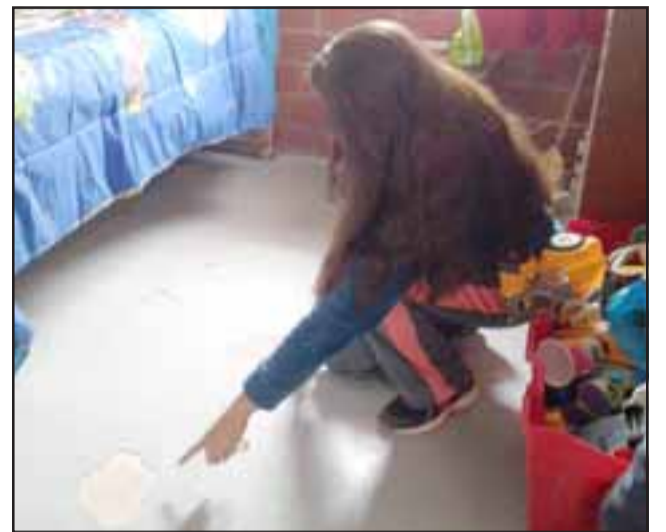
Otro de los problemas que reclamaban los vecinos era el de los pisos que se deterioraron con demasiada facilidad.
