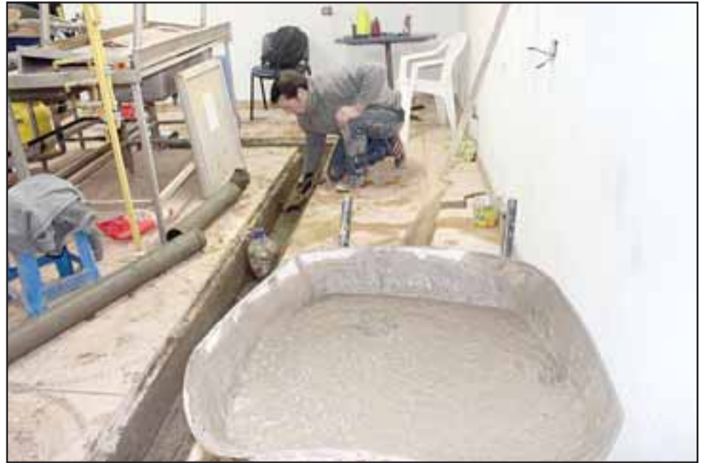
Entre las obras efectuadas se encuentran cambio general de la cerámica, iluminación, mejora de fachada completa y sistema de agua potable.
