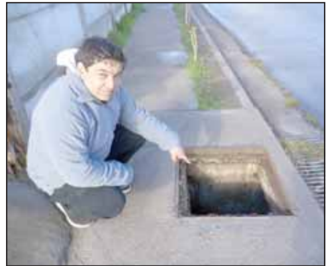
El vecino Cristian Pizarro nos muestra el lugar donde falta la tapa ubicado frente a su casa.
