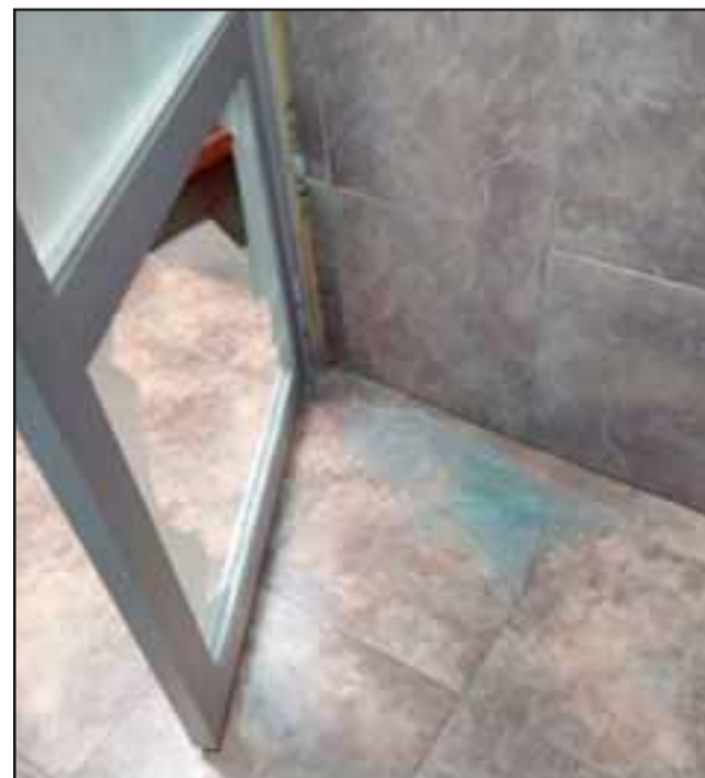
Los sujetos destruyeron una puerta de vidrio para acceder hacia el segundo piso.
