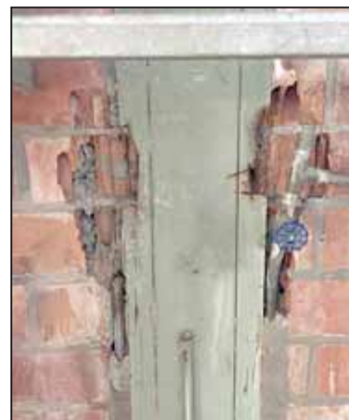
Los delincuentes destruyeron los muros de los camarines para robar las cañerías de cobre.
