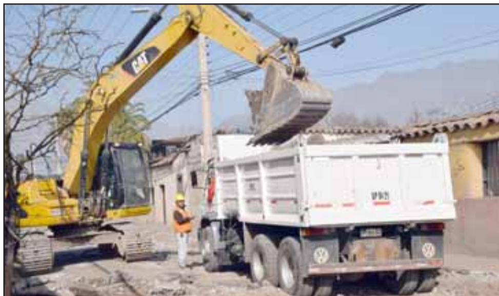
TENDRÁN NUEVA CALLE. - Maquinaria pesada removía ayer lunes el viejo pavimento de Abraham Ahumada, para dar así espacio a una nueva calle.
