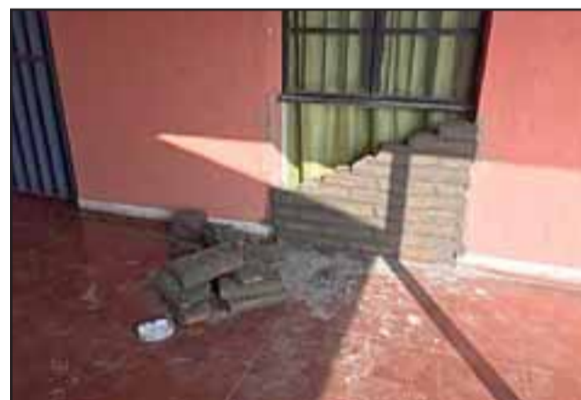
Así de destruida quedó la reparación de un ventanal en el centro comunitario.
