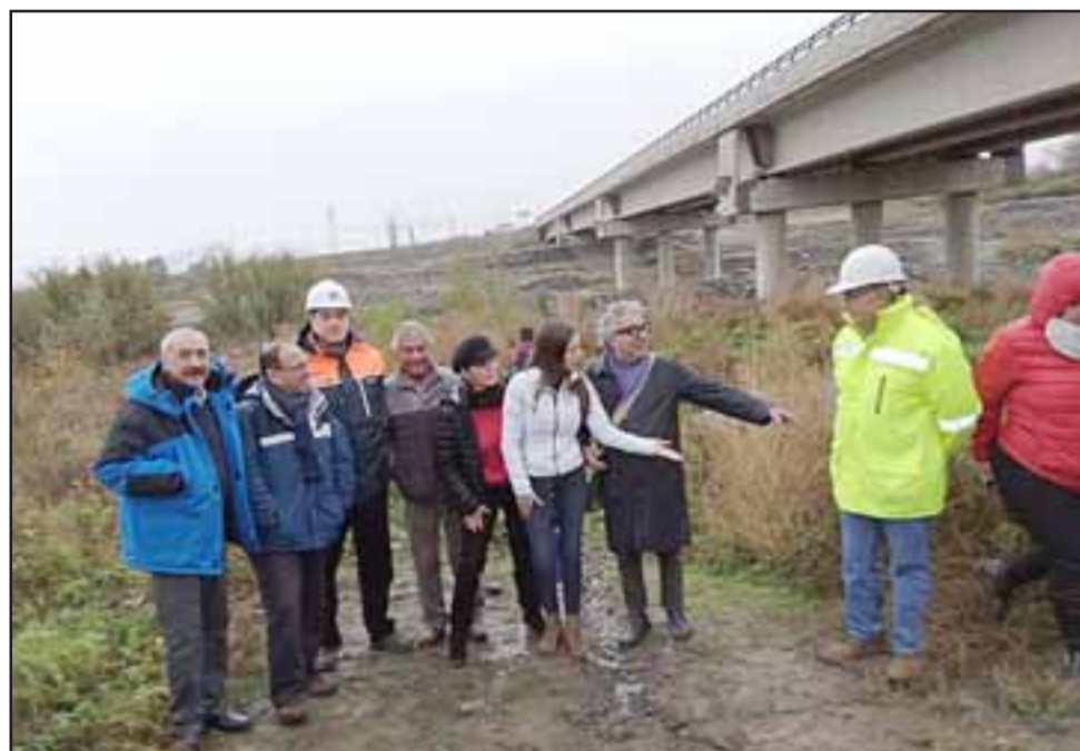
Ya en junio de este año diversas autoridades realizaron una visita al puente para verificar in situ el estado de deterioro a raíz de los trabajos de extracción de áridos que se han efectuado en el sector.
