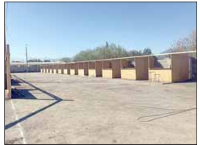
En plena construcción los puestos que se están preparando para las fiestas patrias en Rinconada.
