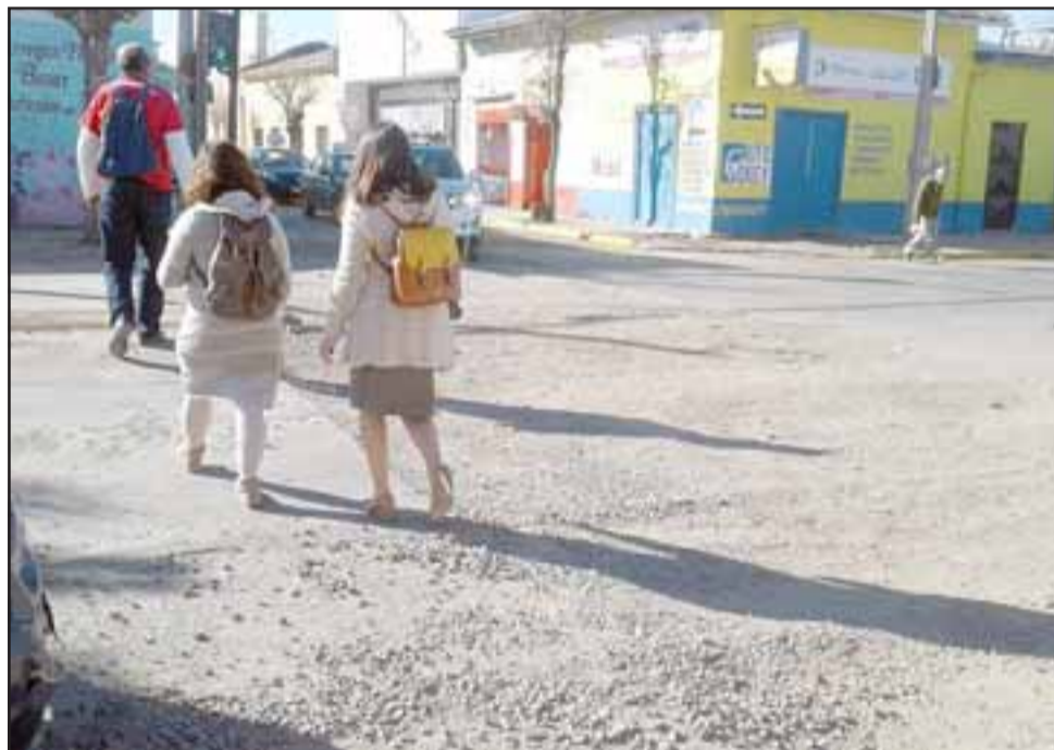
Los peatones también se ven afectados, obligados a transitar por sobre la tierra y las piedras.
