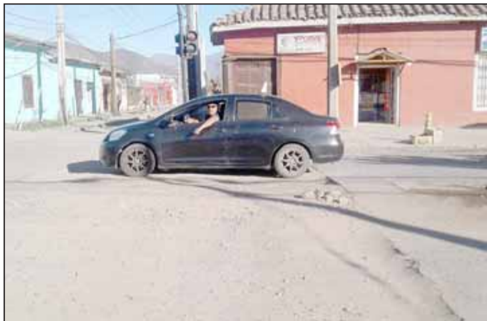
En la imagen se puede apreciar el desnivel que hay en la calzada por donde va circulando el taxi colectivo
