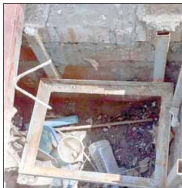
Así quedó la fosa donde estaban instaladas las bombas y control de luces de la Pileta Los Sapitos, la delincuencia sigue destruyendo los bienes públicos.
