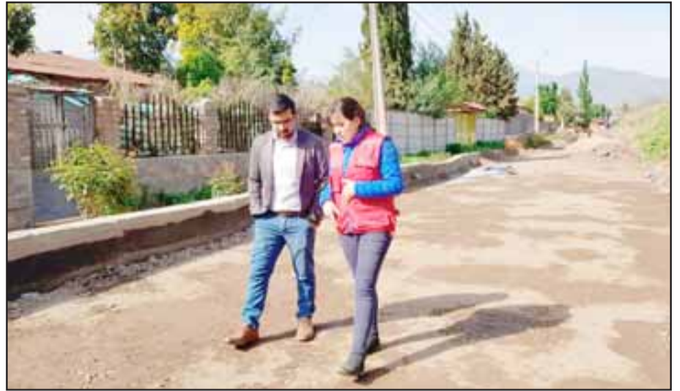
El alcalde Edgardo González junto a la directora de Obras Municipales, Daniela Vargas, inspeccionaron los trabajos de pavimentación de la importante arteria.
