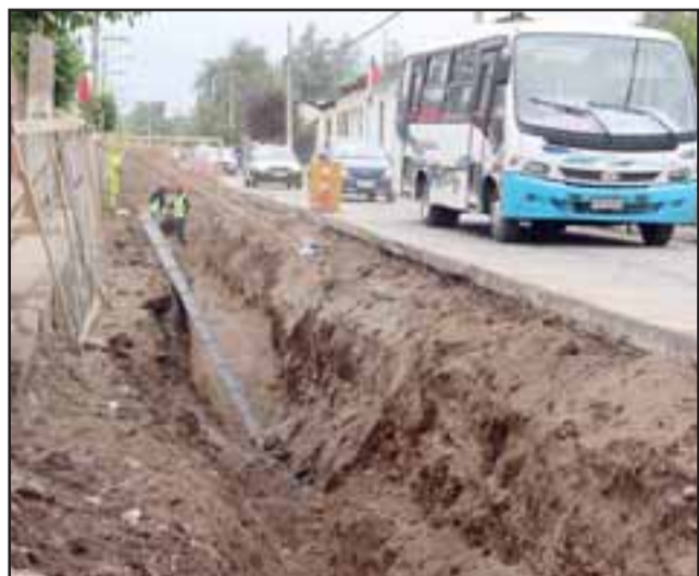
Actualmente se están instalando las uniones domiciliarias en los sectores de San Rafael y Curimón.
