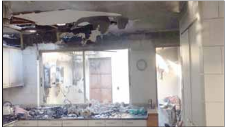
Así quedó la cocina de la casa tras el incendio.
