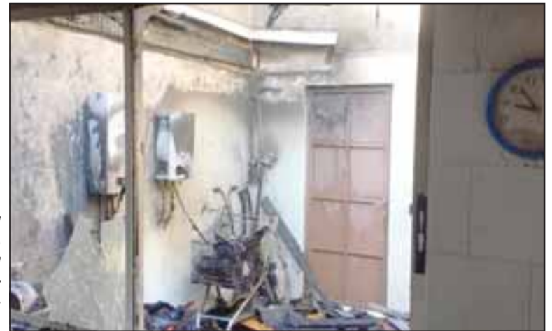
El calefón donde se presume comenzó el incendio que avanzó por el entretecho y causó millonarios daños.
