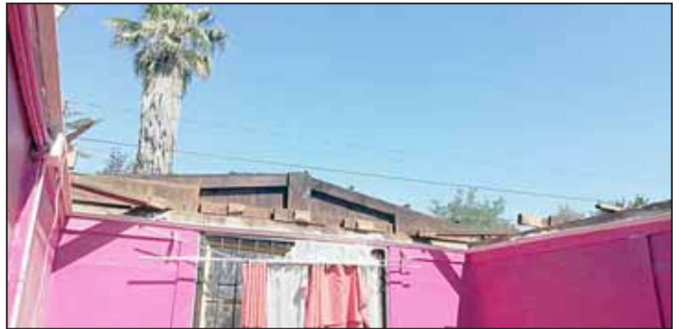
Las pérdidas de las techumbres son evidentes y las familias debieron abandonar los inmuebles, a la espera de lograr reconstruirlas con la ayuda de la comunidad y autoridades.
