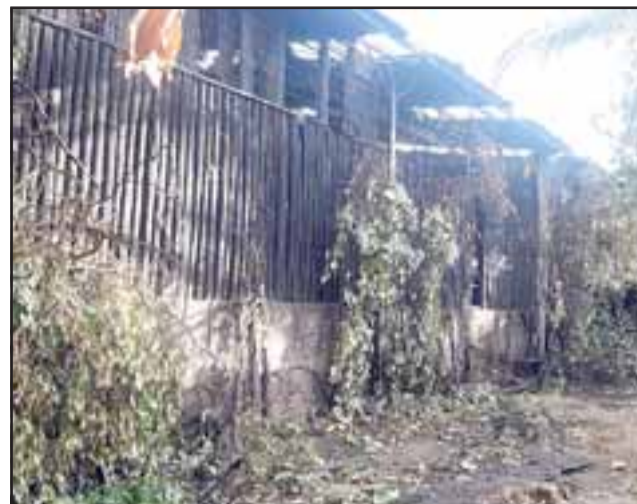
El fuego afectó a una bodega ubicada a un costado de la carretera San Martín en San Felipe.
